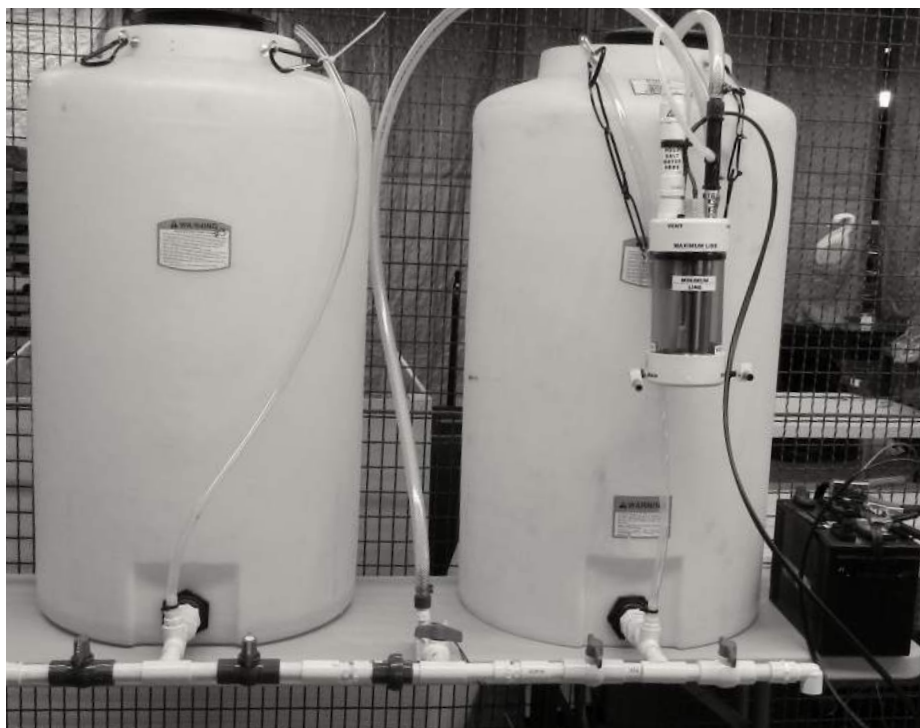
El WaterStep M-100 Generador de Cloro siendo utilizado en un sistema de tratamiento de agua de dos tanques.
